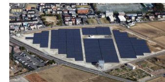
自社保有地(愛知県刈谷市)の太陽光発電所
