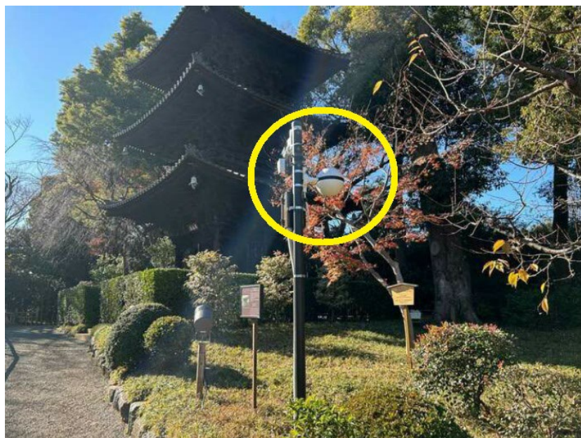
ホテル椿山荘東京の庭園に設置したWi-Fiアクセスポイント (景観を考慮した球体タイプ)
