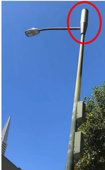
△多周波共用アンテナ （街灯設置タイプ）
