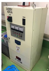
過熱水蒸気発生装置
