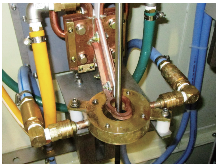
焼入機内(加熱コイル周辺)
