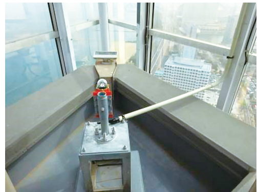
写真4 低光度航空障害灯
