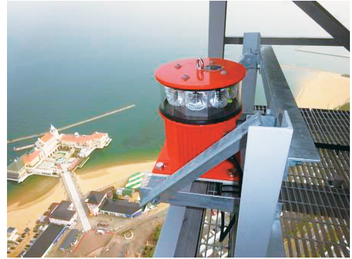
写真3 中光度赤色航空障害灯
