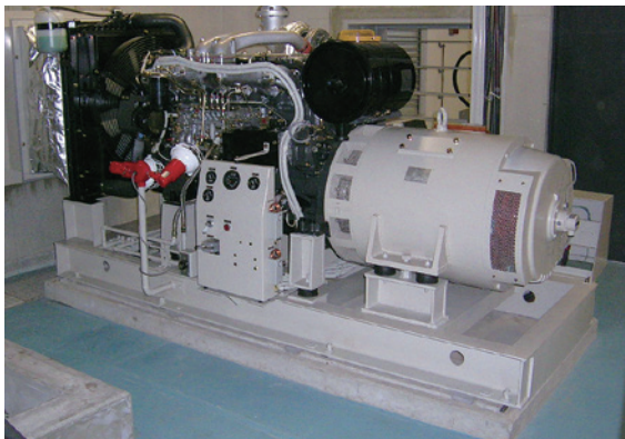
非常用発電装置
