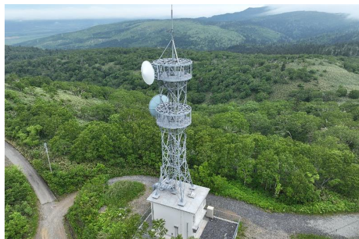
知駒無線中継所
