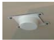
天井取付型アンテナ 地デジ全体域をカバー
