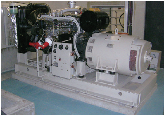
非常用発電装置
