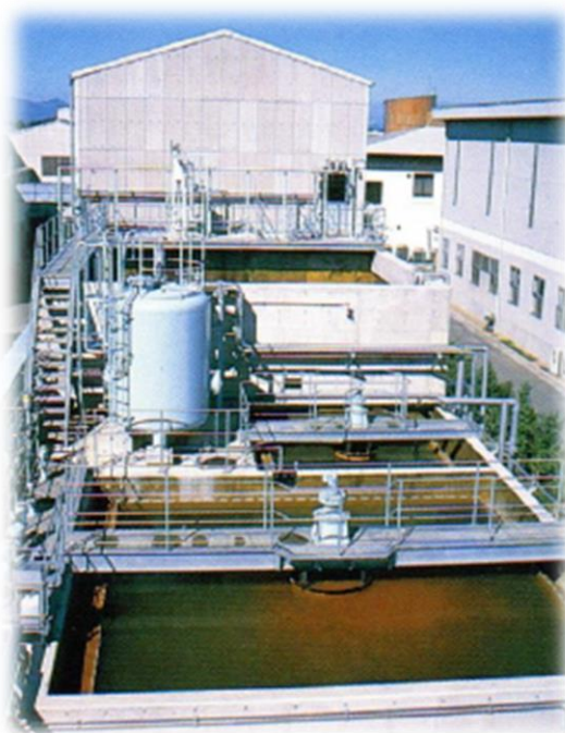
排水処理設備
