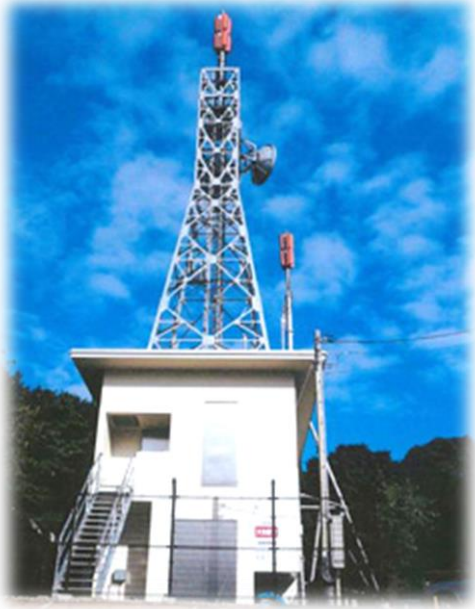
地上デジタル放送設備
