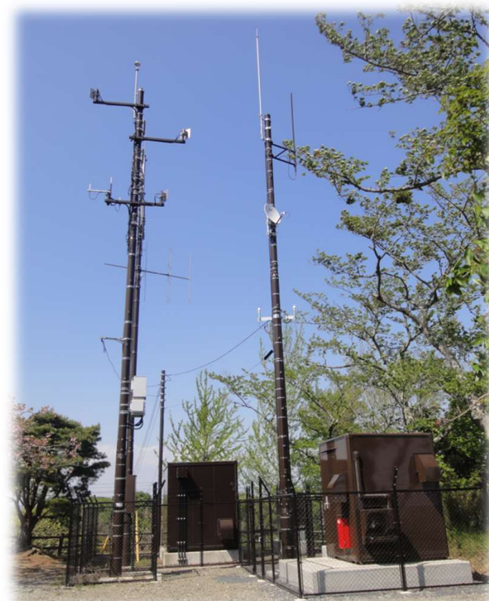
滝山公園に設置された送信局
