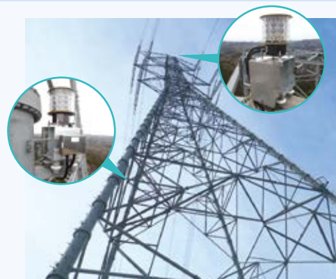
高圧送電鉄塔と設置されたLED航空障害灯
