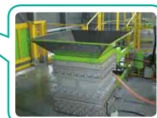
▲ 廃プラスチック投入口
