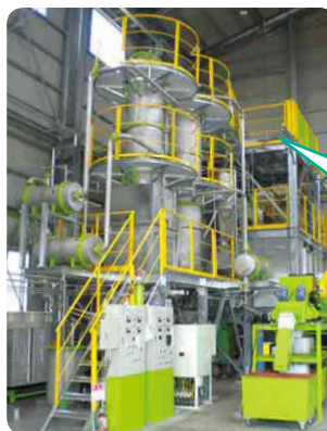
廃プラスチック処理装置
