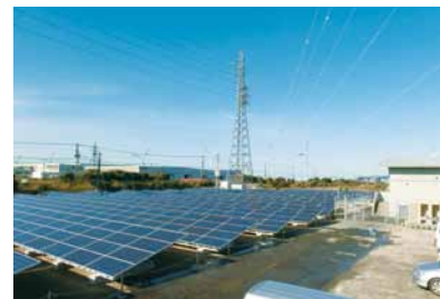
敷地一面に敷き詰められた太陽光パネル
