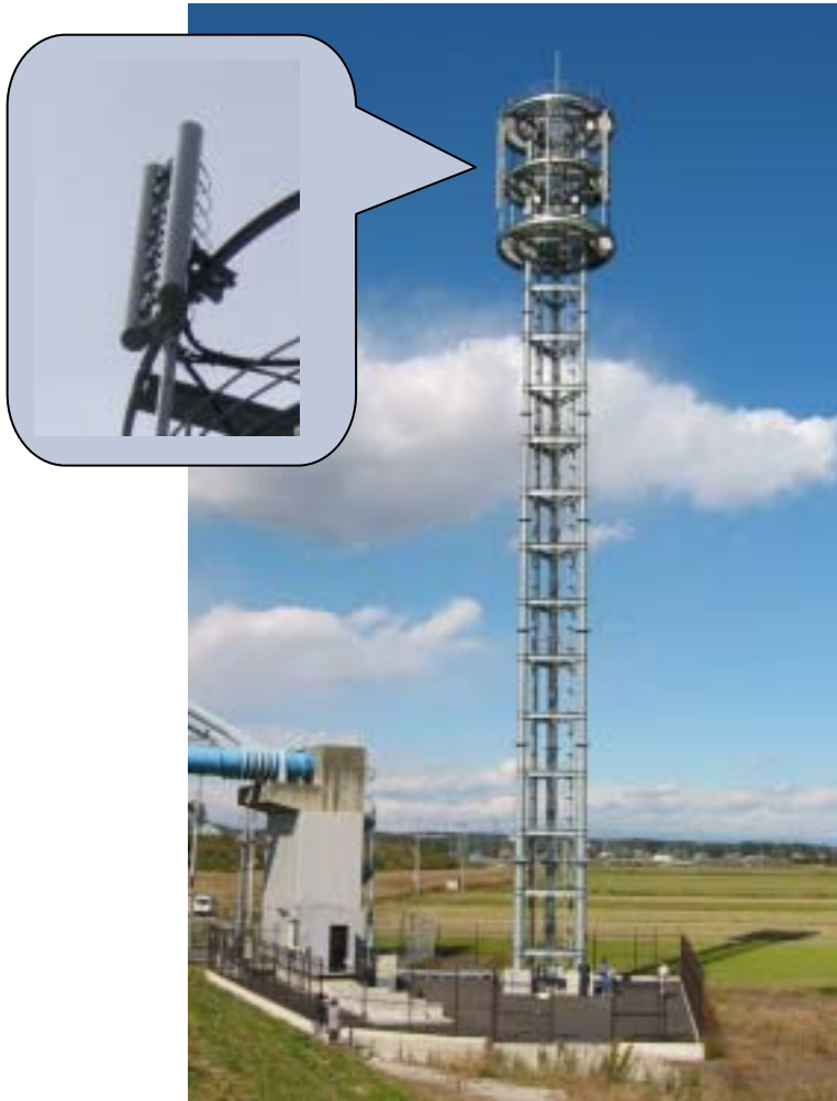
移動体通信用基地局
